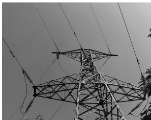
(c) 高压线塔
