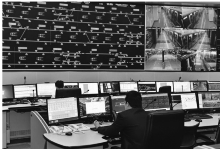
图 1-3 常州地铁控制中心
