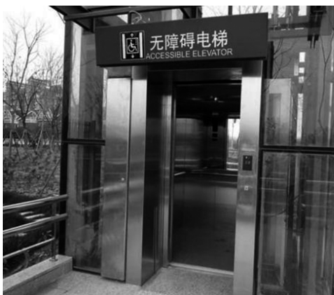
图 1-43 地铁车站无障碍电梯
