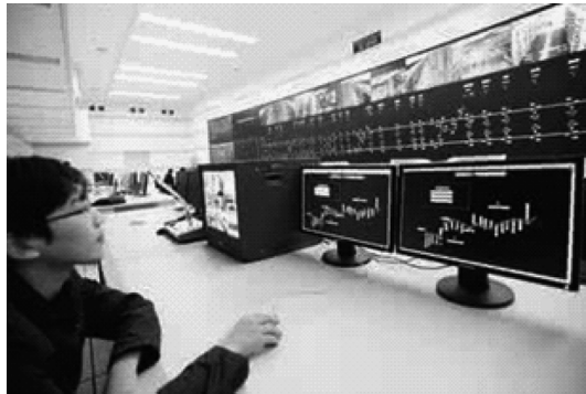
图 1-52 某地铁指挥中心大厅
