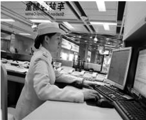
图 1-57 香港地铁车站控制室
