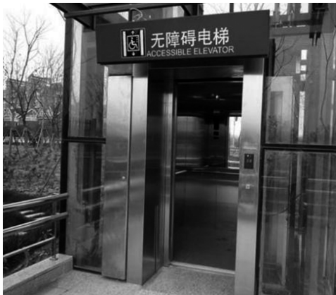
图 1-44 地铁车站无障碍电梯
