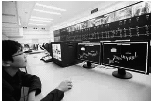
图 1-53 某地铁指挥中心大厅
